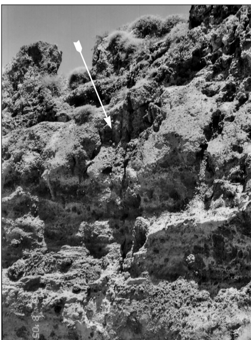
Εμφανέστατη η ρωγμή (βλέπε τόξο) από πάνω έως κάτω προειδοποιεί για τον επερχόμενο κίνδυνο.
